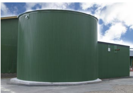
Sprinklercistern med teknik- och pumphus
