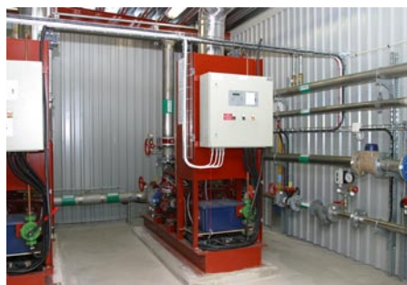
Interiör teknik- och pumphus
