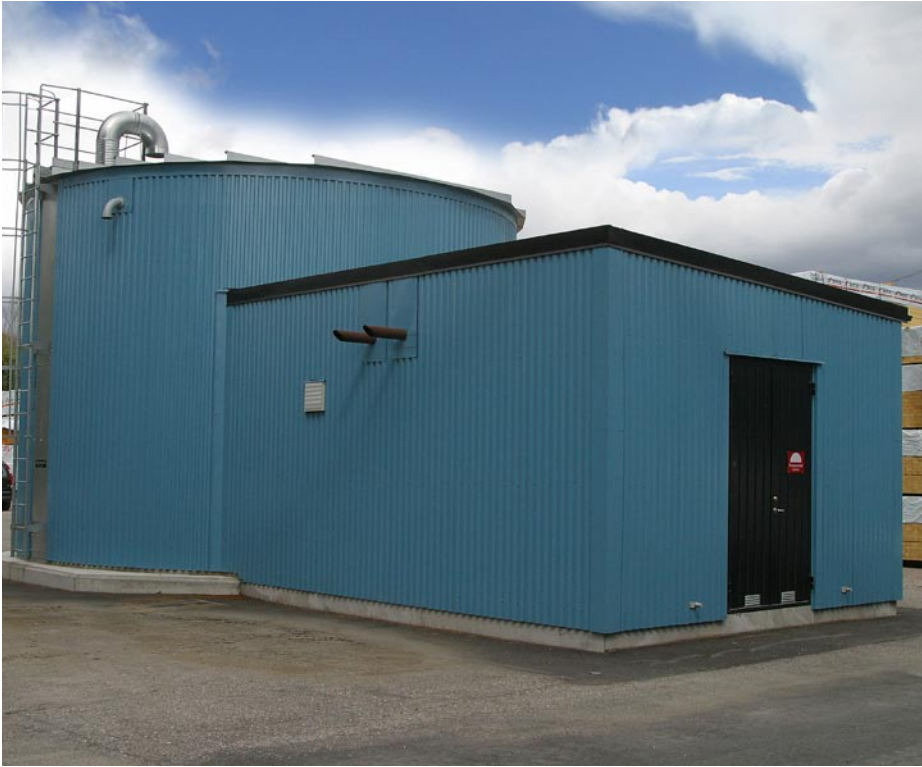
Sprinklercistern med teknik- och pumphus
