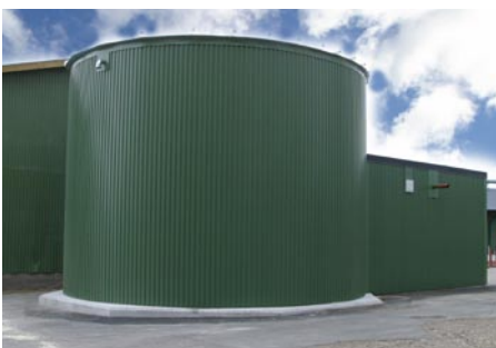
Sprinklercistern med teknik- och pumphus
